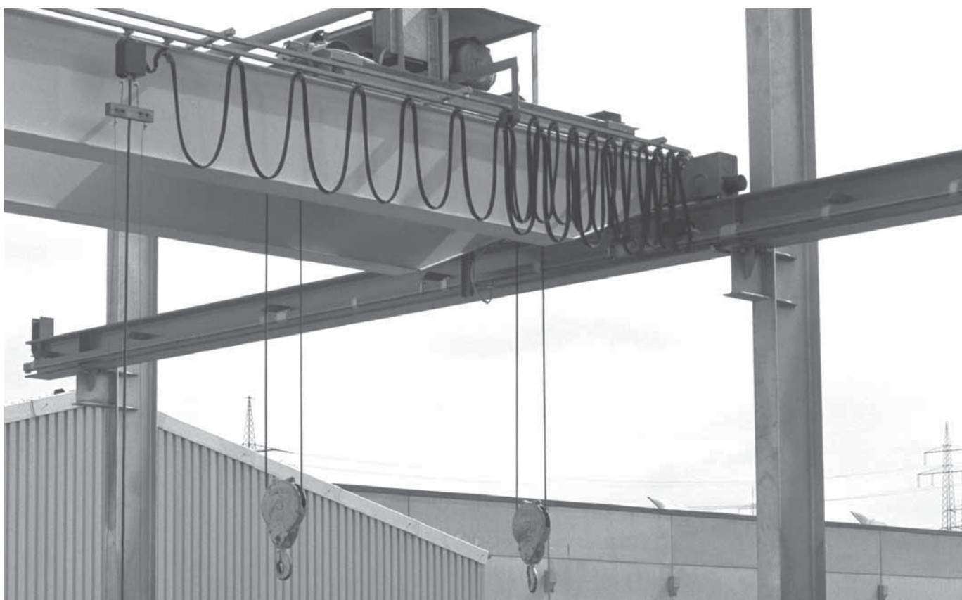
Vedení s kabelovými vozíky pro pojezd jeřábové kočky na jeřábu umístěném ve venkovním prostředí
