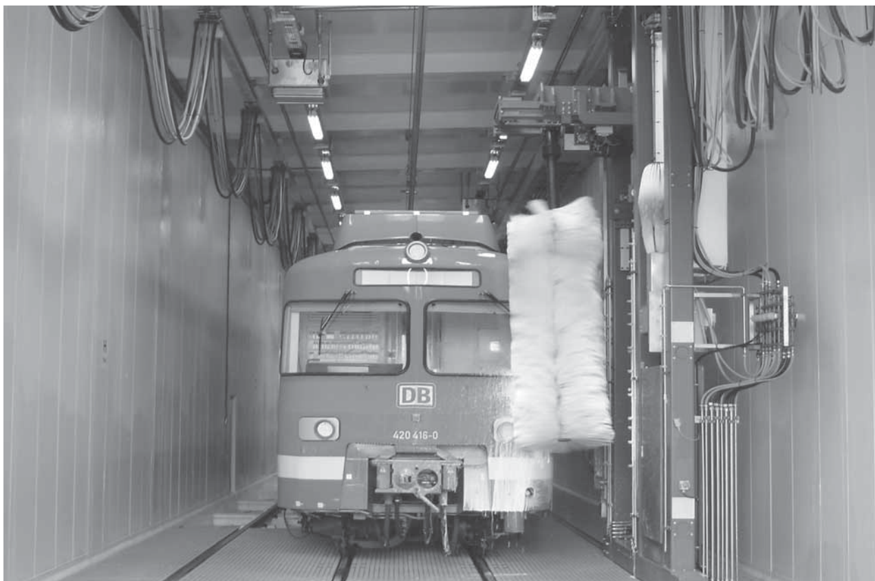
Vedení s kabelovými vozíky v myčce pro železniční vagóny
