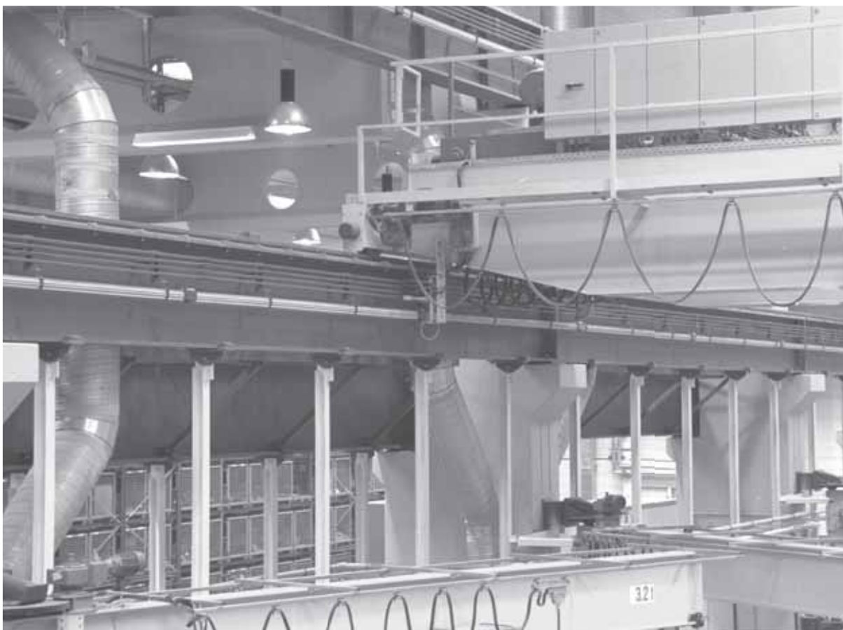
Vedení s kabelovými vozíky pro pojezd jeřábové kočky u halového jeřábu
