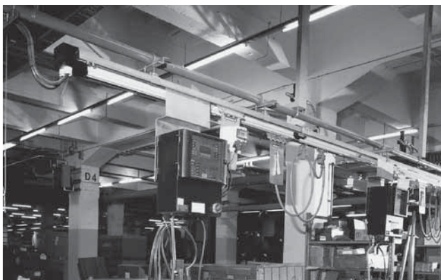
Systém KTW ve výrobním provozu.
