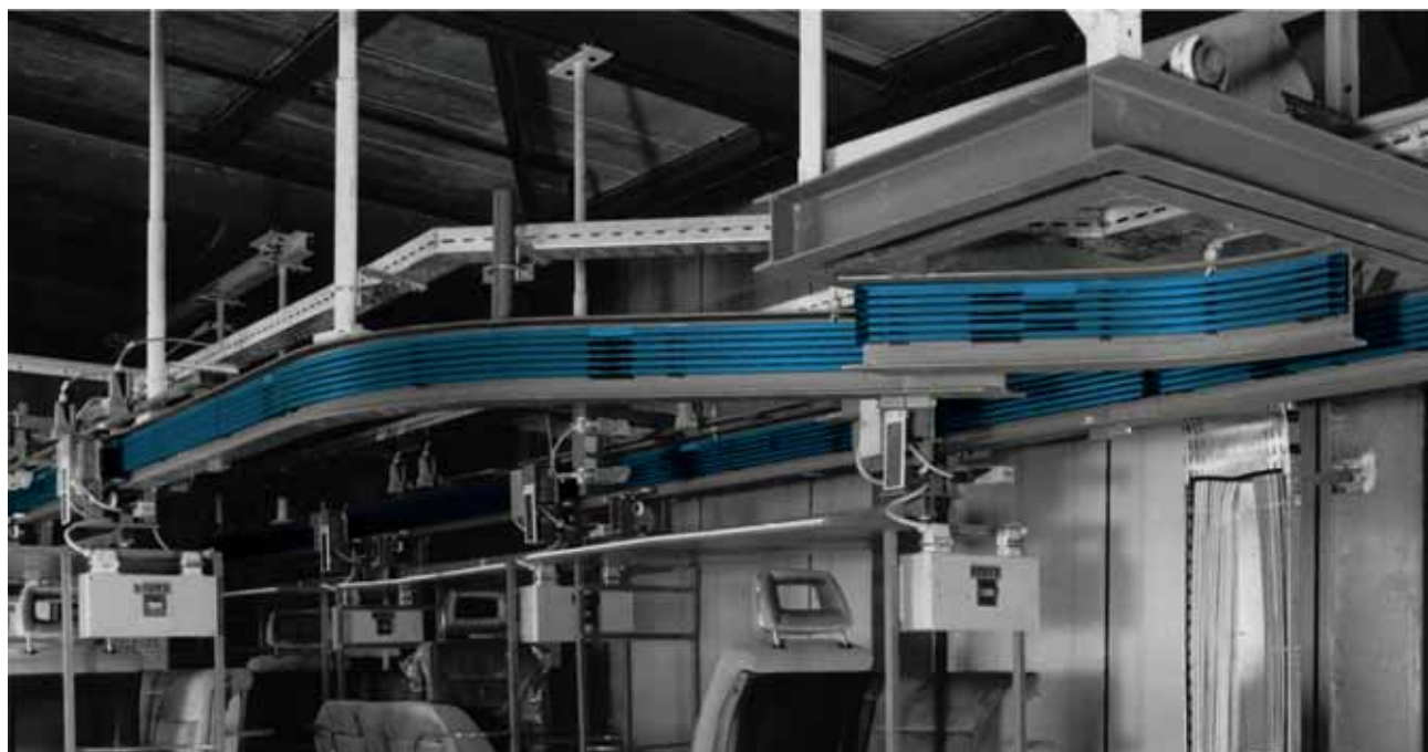
Izolovaná jednopólová trolej U 15, sestavená do 6-pólového trolejového vedení na elektrické podvěsné dráze s posuvnými výhybkami v automobilovém průmyslu.
